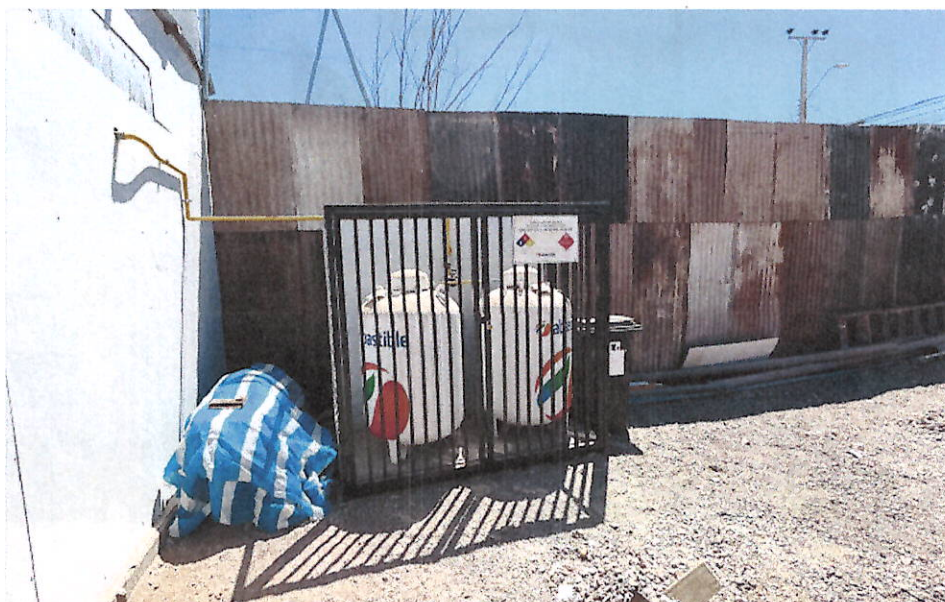
Ilustración 12 – Sector Combustible - Gas
